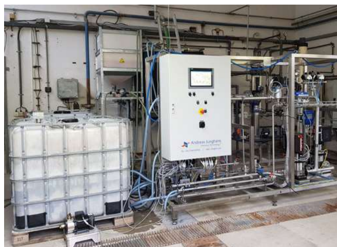
Bild 3: Eingebundene MicroFil-Anlage in einer Abwasserbehandlungsstrecke der Keramikindustrie.
